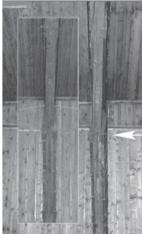
Abb. 9: Dieser Dachträger einer alten Holzbaracke beginnt unter Druck nachzugeben und knickt nach links ein (Pfeil, vgl. Kasten mit einem intakten Träger). Hier zeigt sich andererseits die Stärke von Holz als Baumaterial: es ist ein außerordentlich »geduldiges Material« ...
